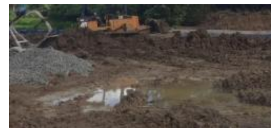
Gambar 7. Genangan air di lokasi akibat tanah labil dan curah hujan tinggi.
